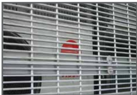
Grillage de protection haute tension
